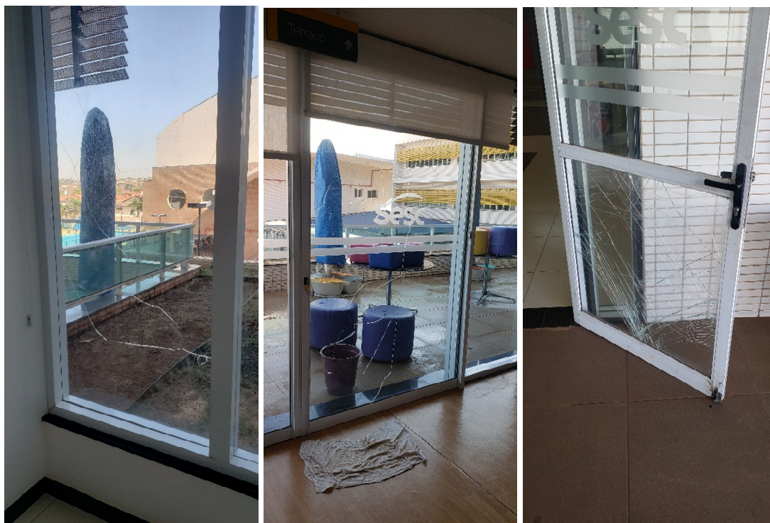
Esquadrias com vidros quebrados
