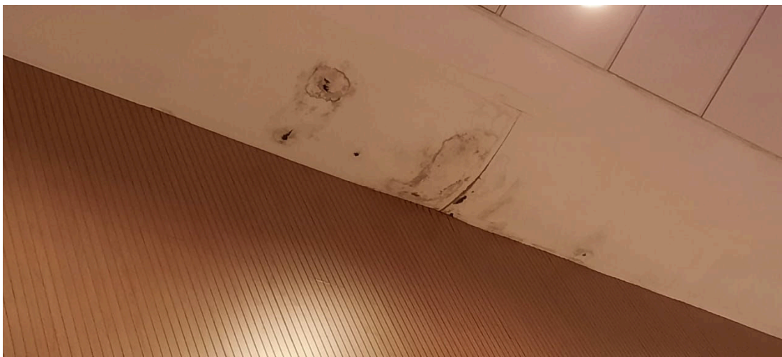
Forro danificado no Auditório
