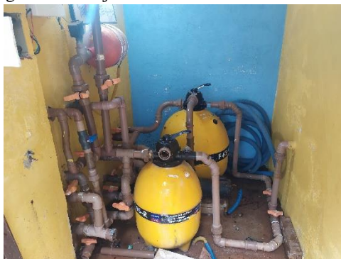
Imagem 07: Conjunto motobomba e filtro da Piscina
