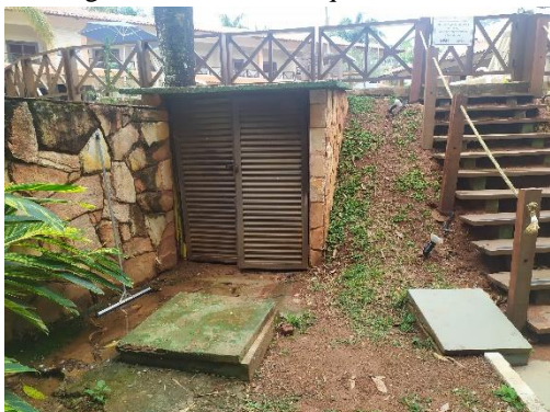
Imagem 06: Casa de máquinas da Piscina
