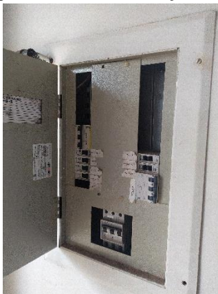
Imagem 08: Quadro de Força da Sauna
